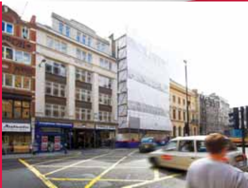
Versterken van betonnen vloerplaten van vijf verdiepingen van Vinci UK Fleet Street , Londen, Verenigd Koninkrijk
