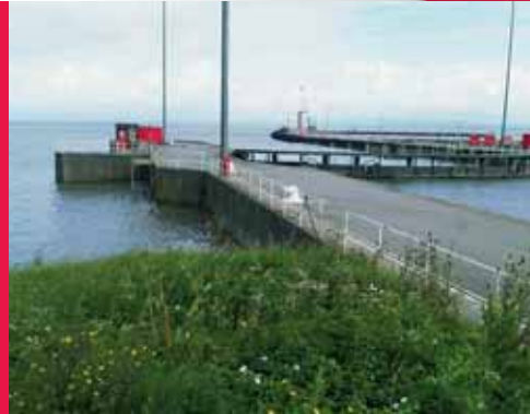
Herstel van scheuren in dokbinnenmuur en langetermijnbescherming tegen instroom van water, Bristol Port , Verenigd Koninkrijk
